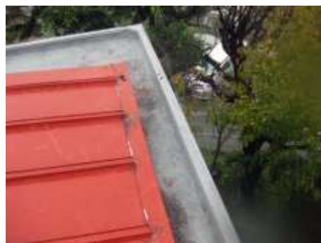
事務所棟雨漏り原因究明 滞水状況
